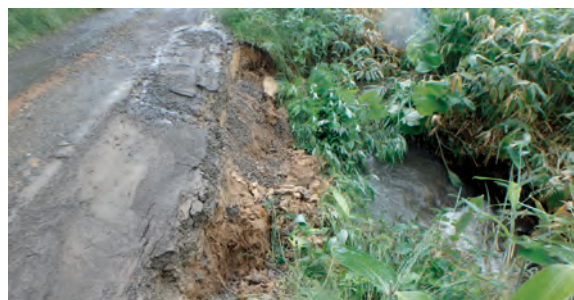
町道菊丘線被災箇所
