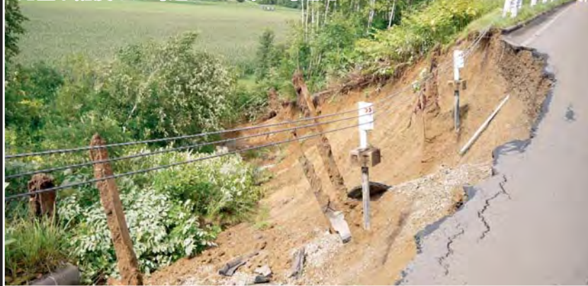
路盤が陥没した町道パンケ東2号道路
