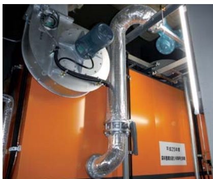
今回導入されたボイラ本体
